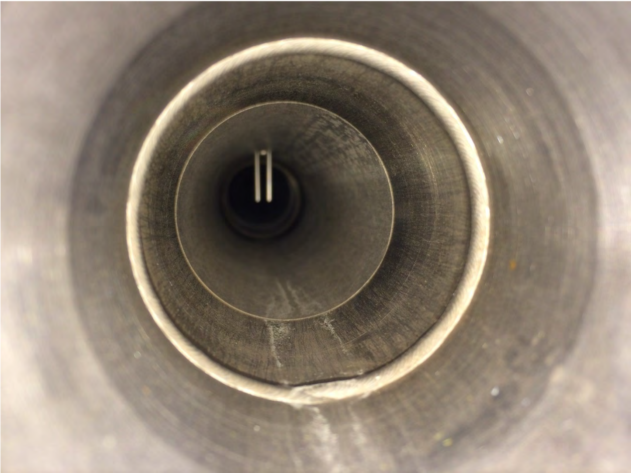
Photo du débitmètre de St-Raymond lors de l'inspection du 3 octobre 2016
