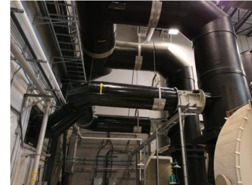
Conduites de ventilation et clapet de décharge
