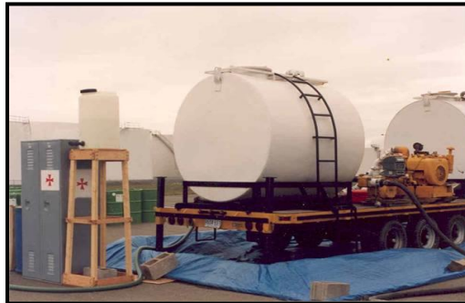
Figure 2.1 Citerne mobile dans un aménagement de rétention
