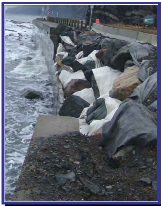
FIGURE 2 : SECTION DE 30 M DE LA PARTIE SUPÉRIEURE DU MUR À RÉPARER (LOUIS BELZILE, MAI 2008).
